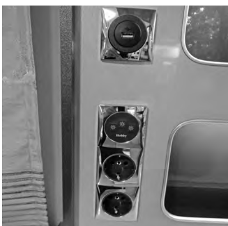
Steckdosen im Innenraum
