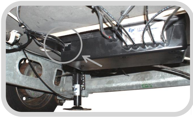
Kunststoffgehäuse mit angeschlossenem Notbetrieb (Handpumpe)
